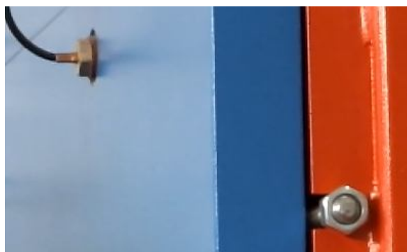
Рисунок 6 – Установка датчика температуры
